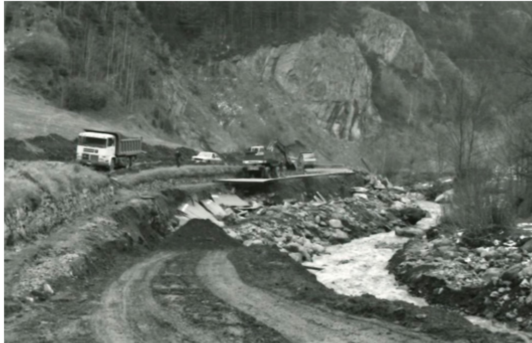
Imatge dels efectes devastadors dels aiguats del 82 a la carretera d'Arinsal. (foto: Antoni Pol, 1982)
